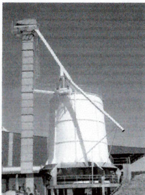
Figura 04: Elevador de canecas alimentando um silo de cereais
